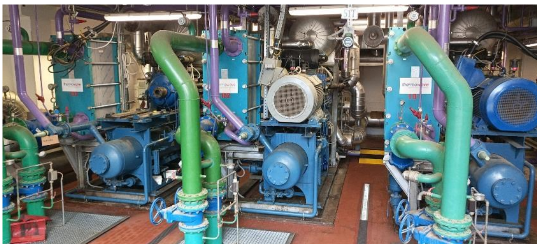
Impianto ammoniaca cella -20 °C
